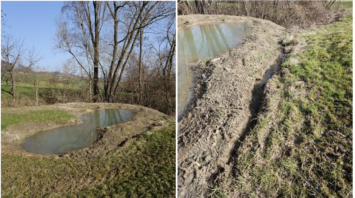
Abbildung 9 Links: Laichgewässer im oberen Bereich. Rechts: Das Bachbett mit dem vermuteten Quellwasseraustritt blieb während der Bauarbeiten unverändert.
